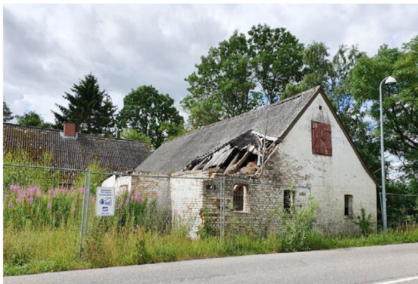
› Faldefærdig gård, som er afskærmet med byggehegn.
