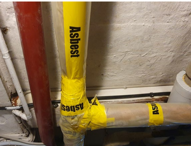
› Asbest i rørisolering i boligblok.
